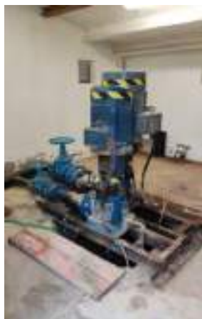
Estació de bombeig el Pou de la Biela, Espluga de Francolí
